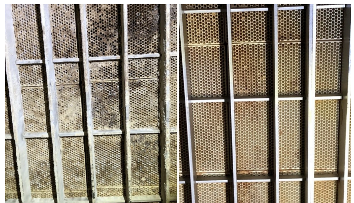
Wabenkörper vorher / nachher – RTO in einem Chemiewerk
